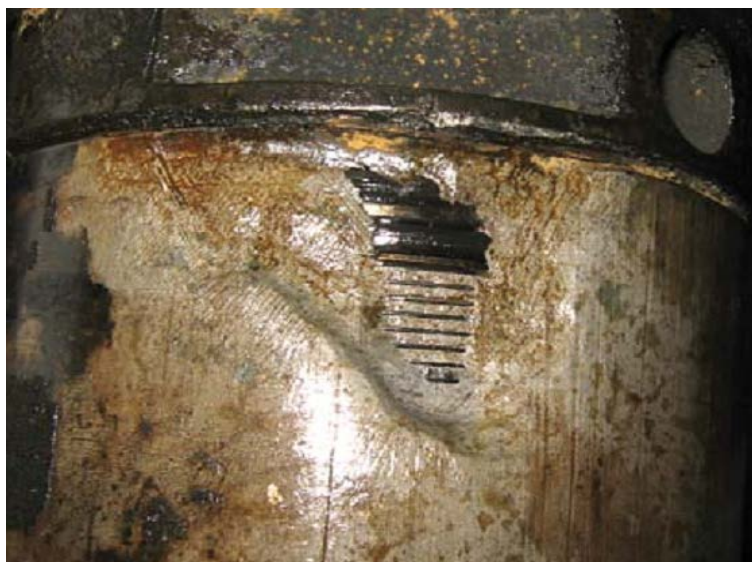
Рис.33. Сквозная коррозия корпуса электродвигателя УЭЦН
